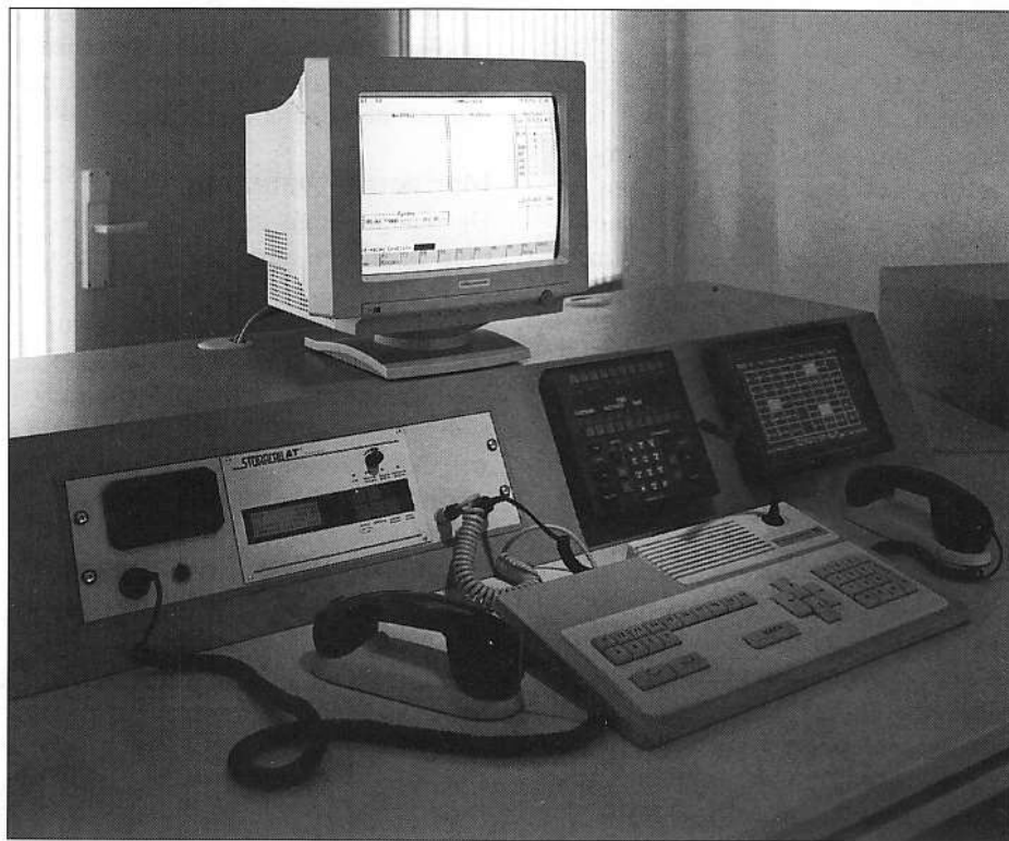
Een voorbeeld van het RDCS-2000 systeem.
